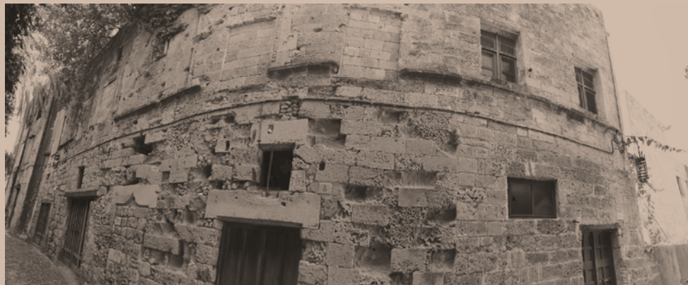
Παράδειγμα τοίχου με ρωγμές στην παλιά πόλη
